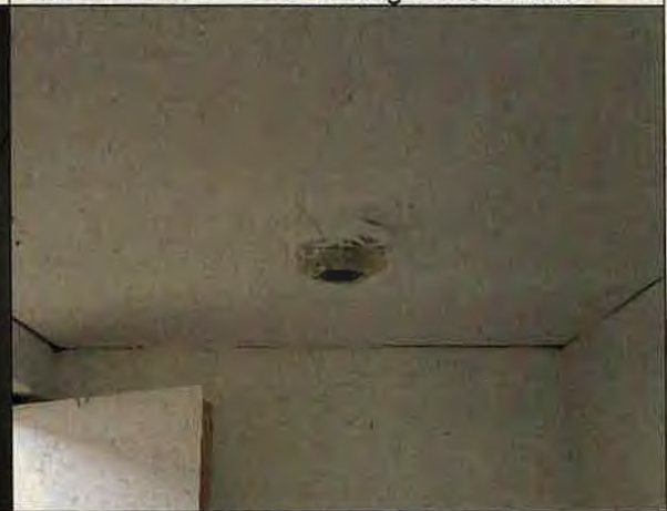
Foto N°10: 16 de mayo de 2018. Cielo casetas sanitarias.
