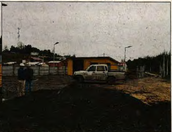
Foto N°8: 16 de mayo de 2018. Planta de tratamientos de aguas servidas.
