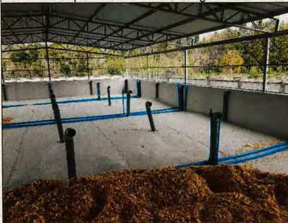
Foto N°5: 10 de mayo de 2018. Lecho biológico.
