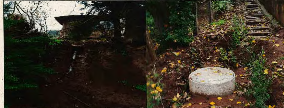
Foto N°29: 16 de mayo de 2018. Red de alcantarillado.
