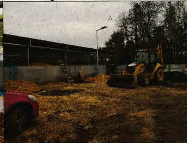
Foto N°6: 16 de mayo de 2018. Planta de tratamientos de aguas servidas.
